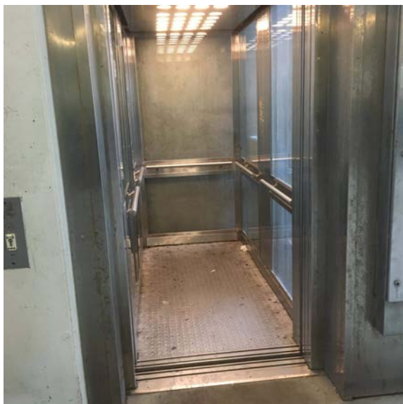
Bild 27. Ostädad och illaluktande hissutrymme.
